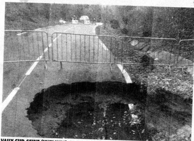
VAUX-SUR-SEINE (YVELINES). La RD 17 s'effondre aux abords de la forêt de l'Hautil. Un énorme trou a coupé la circulation.
